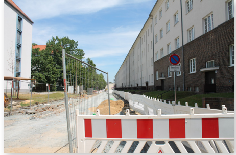
Unfallgefahr: Baustelle No. 659 (Chemnitz)
